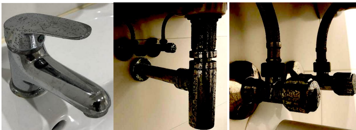
Obrázek 6: Příklad poškozených sanitárních prvků
